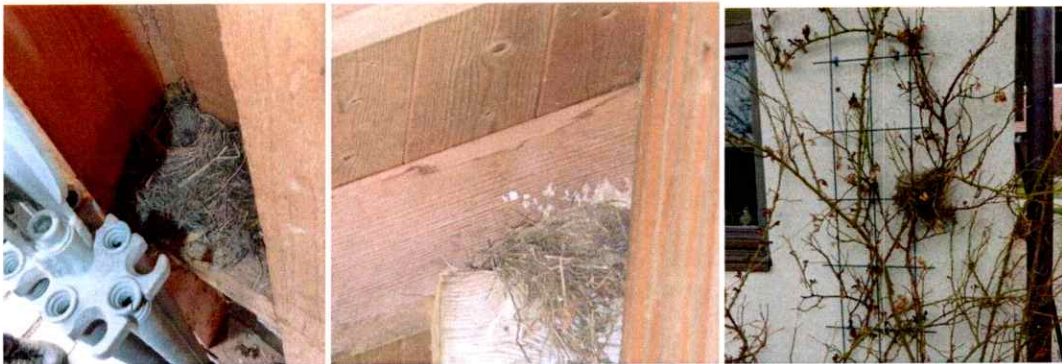
Diverse Singvogelnester in der Maschinenhalle (links), am Altbestand unter dem Dach (mitte) bzw. in einem Spalier des Wohnhauses (rechts)
